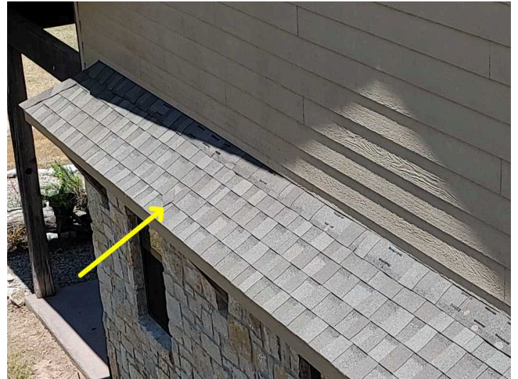
Loose shingle tab(s)
